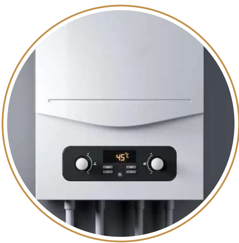
квартиры оборудованы двухконтурным газовым котлом
